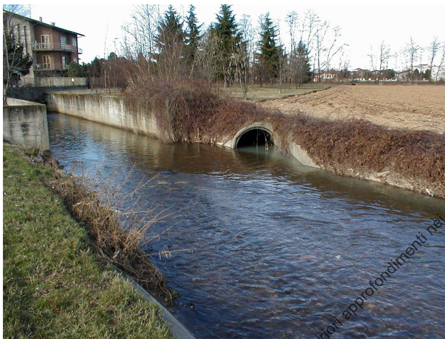
Figura 4. Scarico in Bozzente del sistema di drenaggio di Lainate.
