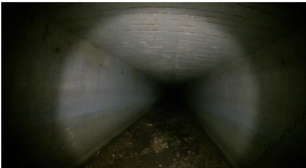
Figura 49 - interno dello scolmatore del Bozzente - degrado della soletta in calcestruzzo
