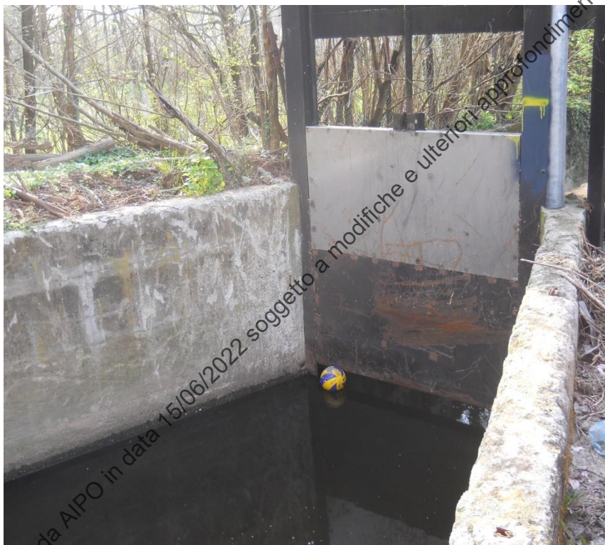
Figura 3. Paratoia a valle del deviatore del Bozzente.
