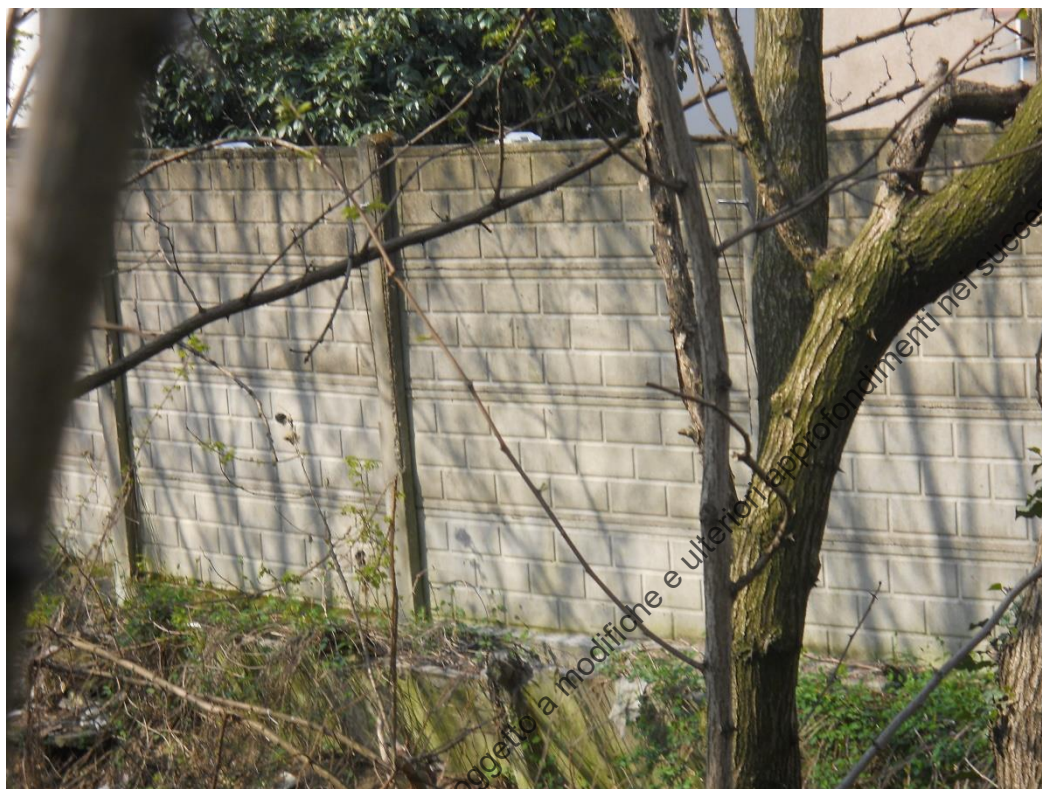
Figura 8. Muro di recinzione pericolante in frodo al torrente in località Biringhello.
